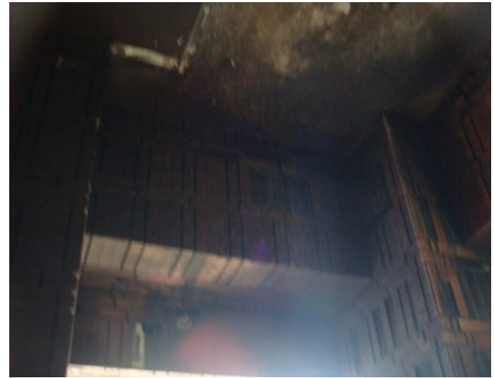
潔淨室內部天花板煙燻後碳化物遺留情形
